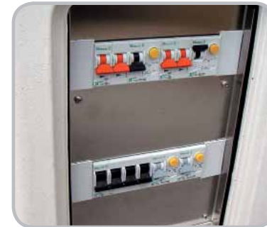
Panneau des interrupteurs de protection
